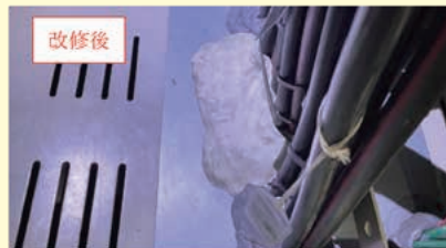
写真. 電気絶縁性パテ脱落箇所
