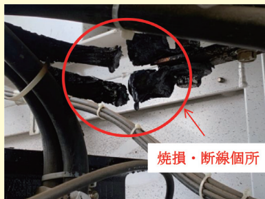
写真 パワコン負荷側ケーブルが焼損し断線 (2本で1相分)
