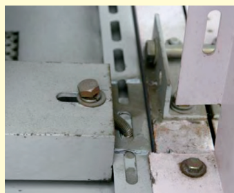
図-3 変圧器固定部損傷
